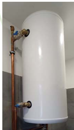
Rézcsővel csatlakoztatott melegvítartoló, hiányzik: tároló földelés és dielektromos közcsavar (plusz tágulási tartály).
