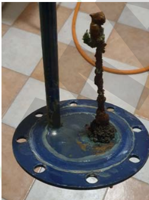
Elektrokémiai korrózió egyik következménye a gyors anódfogyás, ezért indokolt az első anódcseré 12 hónaponál, így annak jelentős fogyása esetén még idejében feltárható a probléma a tároló test sérülése nélkül (azt követően 18 hónap).
